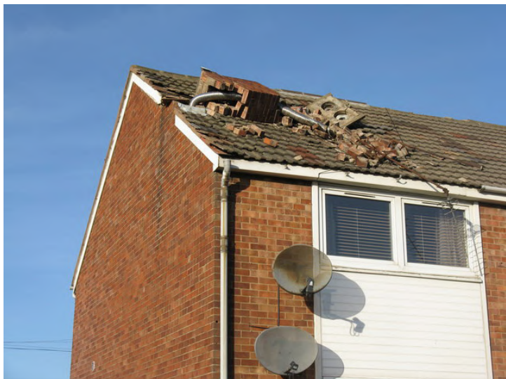
Bâtiment endommagé par une tempête (Edimbourg, Grande-Bretagne)
